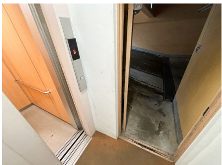
エレベーター
