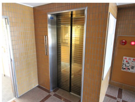
エレベーター
