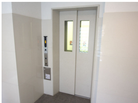
エレベーター
