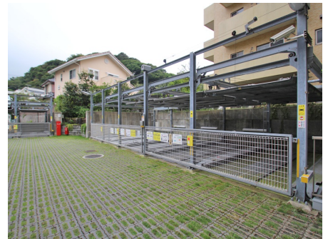
機械式駐車場
