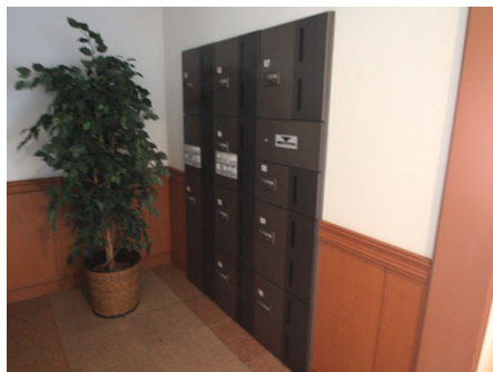
宅配ロッカー
