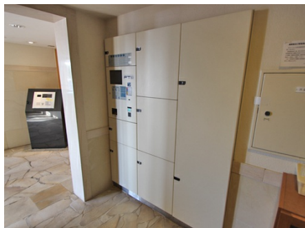
宅配ボックス
