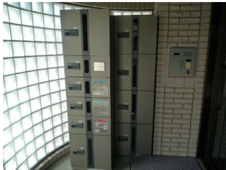
宅配ボックス
